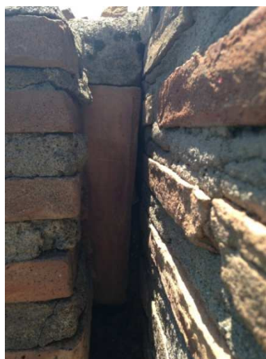
Figura 101 e 102: alloggio tubatura tra pilastro ovest e muro perimetrale ovest. Ninfeo Ovest - Minturnae.
