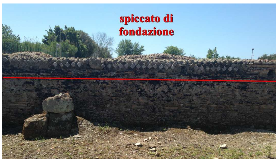
Figura 42: muro perimetrale nord, facciata posteriore, dettaglio spicco di fondazione. Ninfeo Est - Minturnae.
