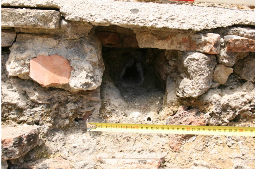
Foto 13: Tubo in piombo sul lato sud della parete centrale.
