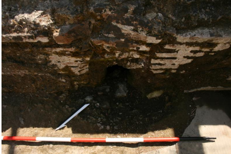
Foto 36: Foro angolo destro parete est.
